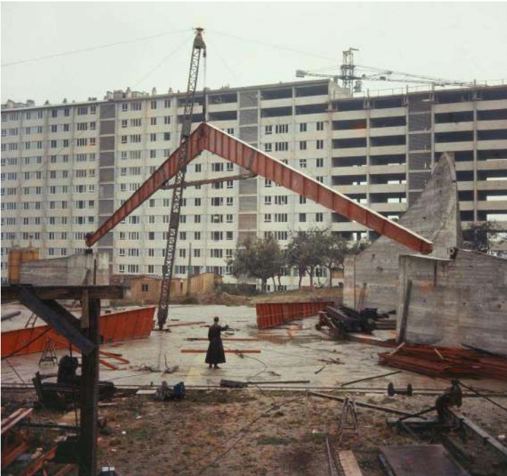
Septembre 1961, les poutres métalliques de la toiture arrivent sur le chantier sous le regard attentif de l'abbé Vailland.
